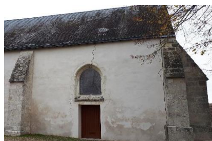
Fissure de l'église (janvier 2021)
